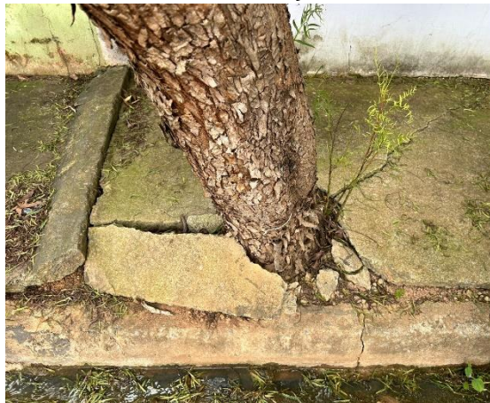
Figura 03: Danos causados pelas raízes da árvore 1 na calçada.
